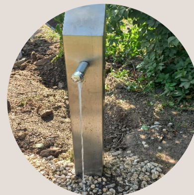
Neu installierter Trinkwasserbrunnen beim Spielplatz in Zillingtal
